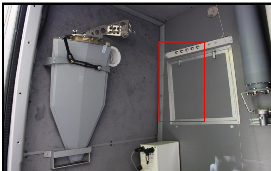
14. attēls. Kabeļu novietojuma stiprinājumi pie sienas.
